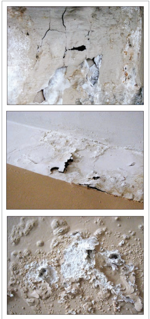
Рис. 3. Повреждения микроскопическими грибами стен помещений
